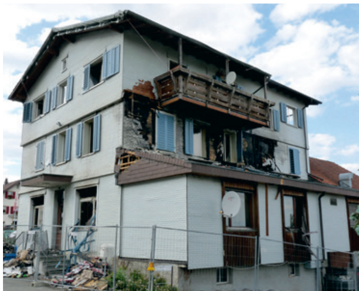
So sieht das ehemalige Restaurant «Frohheim» nach dem Brand aus. Bilder: zg
