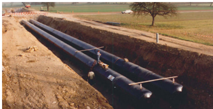
Baustelle mit beachtlichen Ausmassen: Aufnahme vom Bau des Röhrenspeichers in der Oberzelg im Herbst 1989. Foto: ibw
