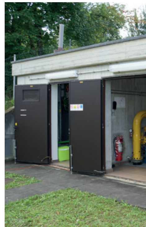
Die Druckreduzier- und Messstation (DRM) in der Oberzelg.
